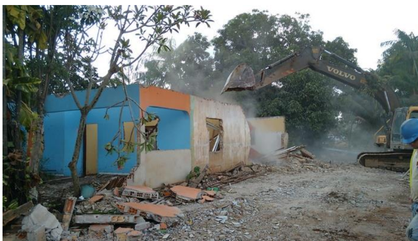
(Casa da moradora e líder ribeirinha Antônia sendo destruída pelo Consórcio Norte Energia, responsável pela construção da hidrelétrica de Belo Monte. Foto: Sabrina Nascimento, publicada em 2015. 173 )
